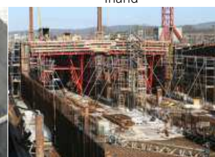
Unterwassertunnel Limerick Irland
